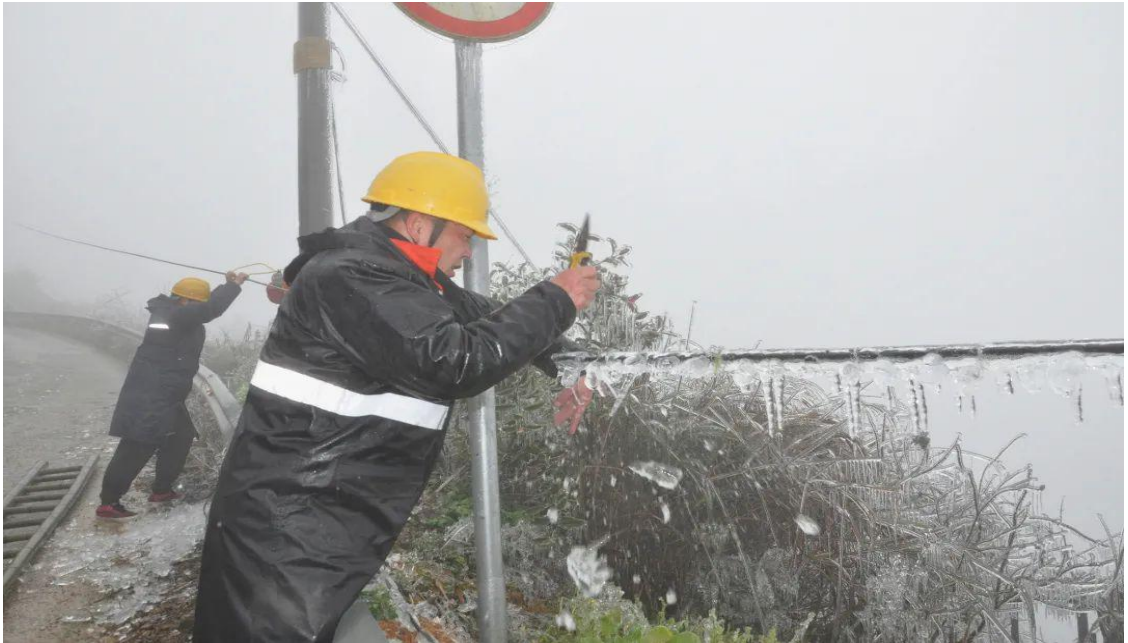
图为：供电所员工顶风冒雨正在对覆冰线路进行除冰
